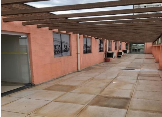
Figura 4 – Piso a ser retirado apresentando deformações
