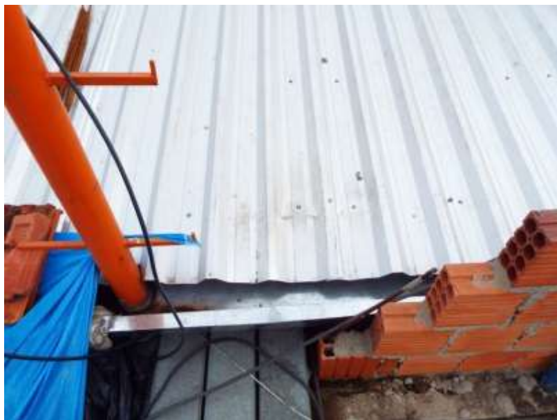
Foto 09 – Trecho 2A Antena – obstruindo a calha
