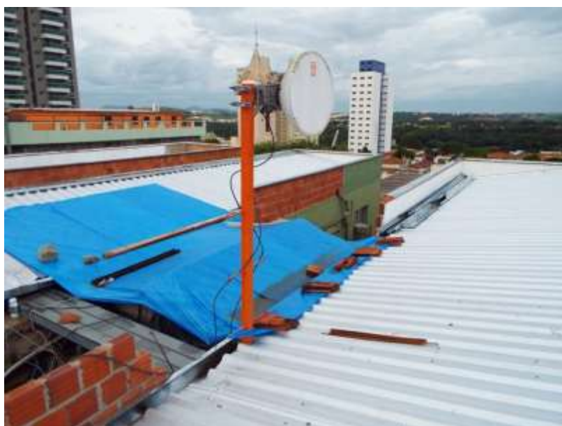
Foto 10 – Trecho 2A Antena – obstruindo a calha Deveria ser instalada na laje técnica
