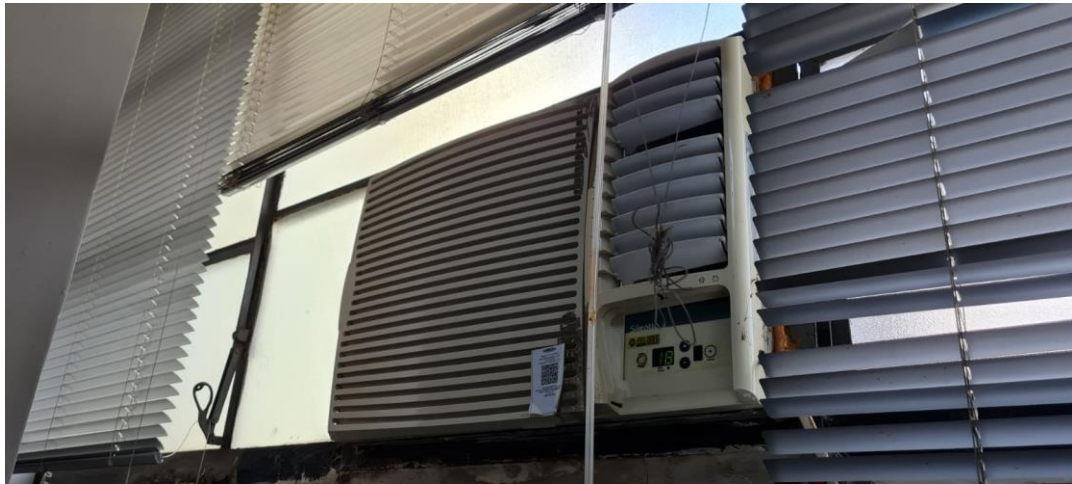
Figura 3 - Aparelho instalado no gabinete do vereador Anilton Rissato
